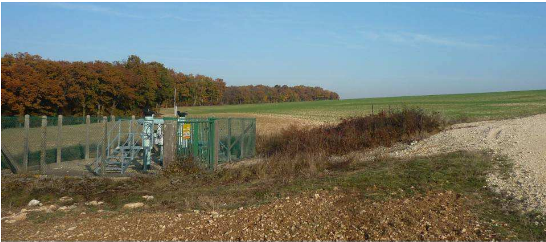
Figure 6 - Poste de sectionnement (entouré d'un grillage)
